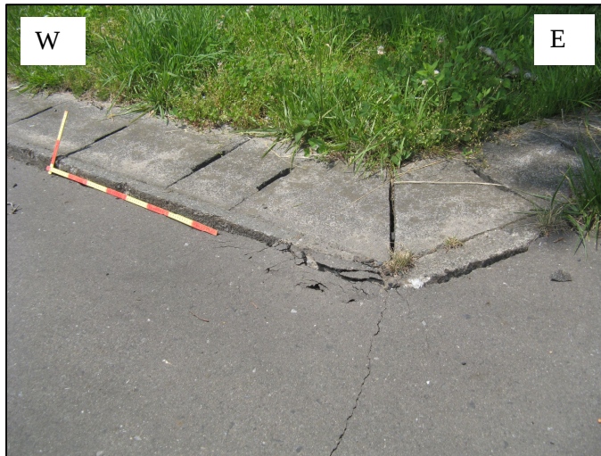
図4 国道342号線若神子地点の歩道に生じた短縮変形。側溝が曲がる箇所のアスファルトは、短縮により破壊され、飛び散っている。その後方のスケールが置いてある箇所は4cmほど沈降している。このことから、この短縮変形は伏在する西傾斜の逆断層の変位で生じたと推定される。
