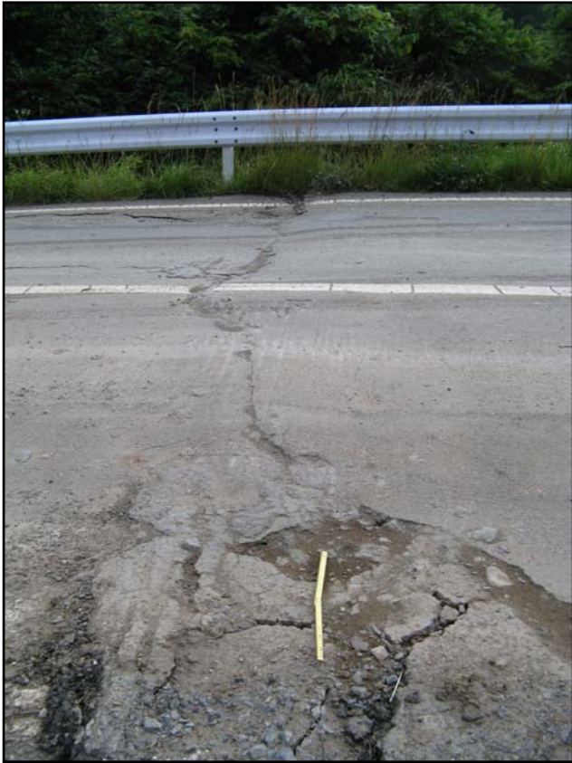
図 4. 市野々原南東の国道 342 号線にあらわれた逆断層です。断層の走向は N27^{\circ} E で、写真右側（北西側）のアスファルトが左側のアスファルトの上にのり上がり、アスファルトが 2～3cm 重なっています。断層右側のアスファルトは 10cm ほど隆起しています。後方のガードレールは、短縮にともなってゆるく湾曲しています。スケール（40cm 長）をおいたところのアスファルトは、短縮にともなって割れています。これらの状況から、断層は北西傾斜で北西上りの逆断層と判断できます。2008 年 7 月 9 日撮影。
